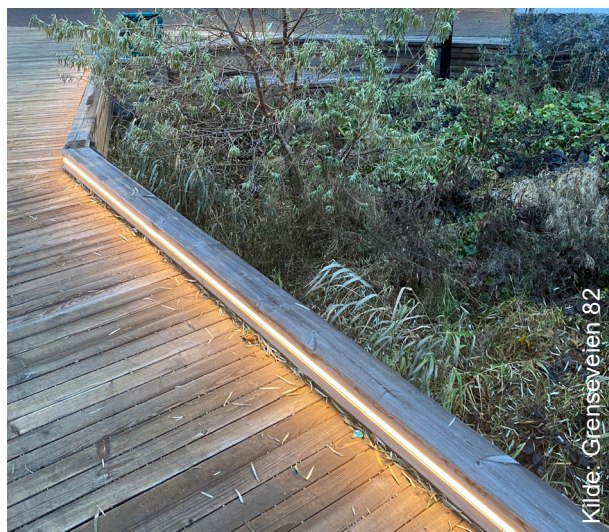
Kant i tre med integrert belysning. Ikke luft mellom kant og tredekke.
