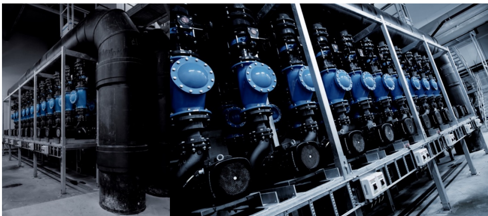
FIGUR 18 - INTERNT VANNSYSTEM MED TØRROPPSTILTE PUMPER OG LUKKEDE RØRSYSTEM. KILDE: AKVAGROUP
