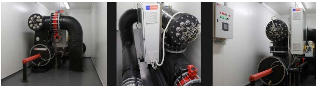
FIGUR 3 - UW- STASJON MED AKVAFILTER
